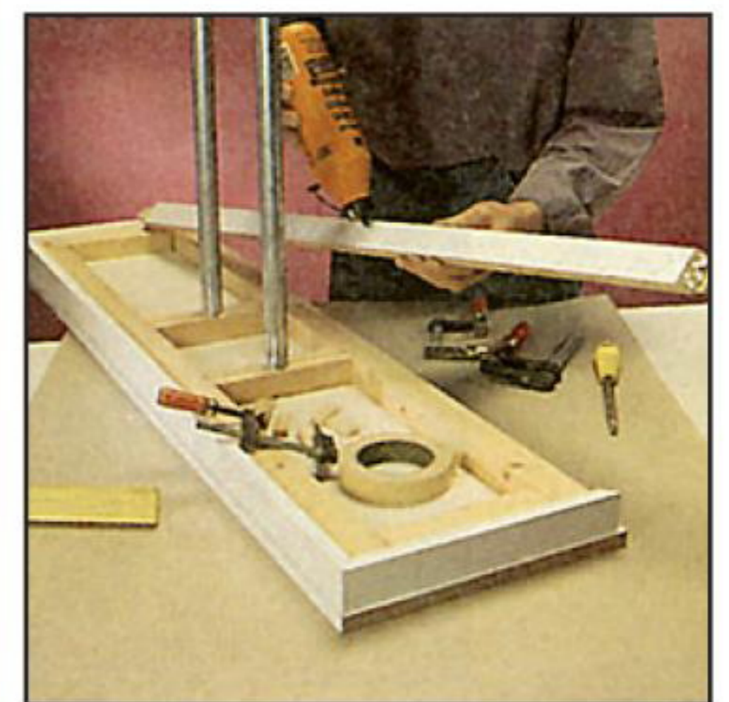
Подстолье из брусков, облицованных кромочными накладками, установлено на стальные трубы-стойки. Кромочные накладки соединены на ус друг с другом и приклеены к раме подстолья.
