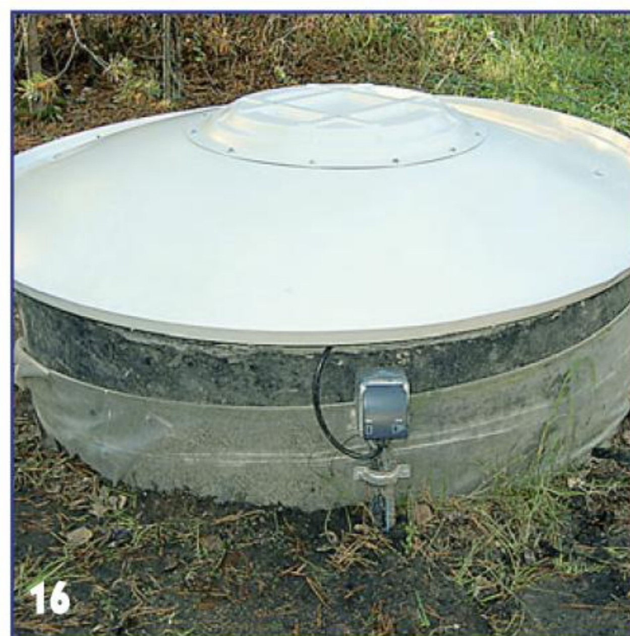
Розетка для подключения насоса закреплена на внешней стороне верхнего кольца.
