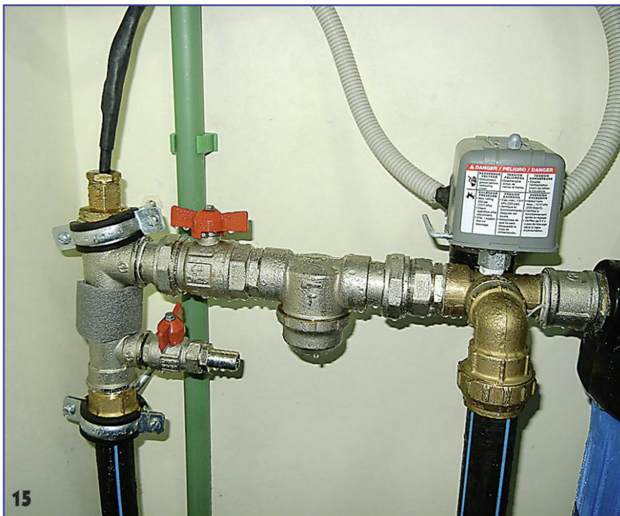
Узел на входе водопровода в дом: подключённый греющий кабель и реле давления Shneider, управляющее насосом.
