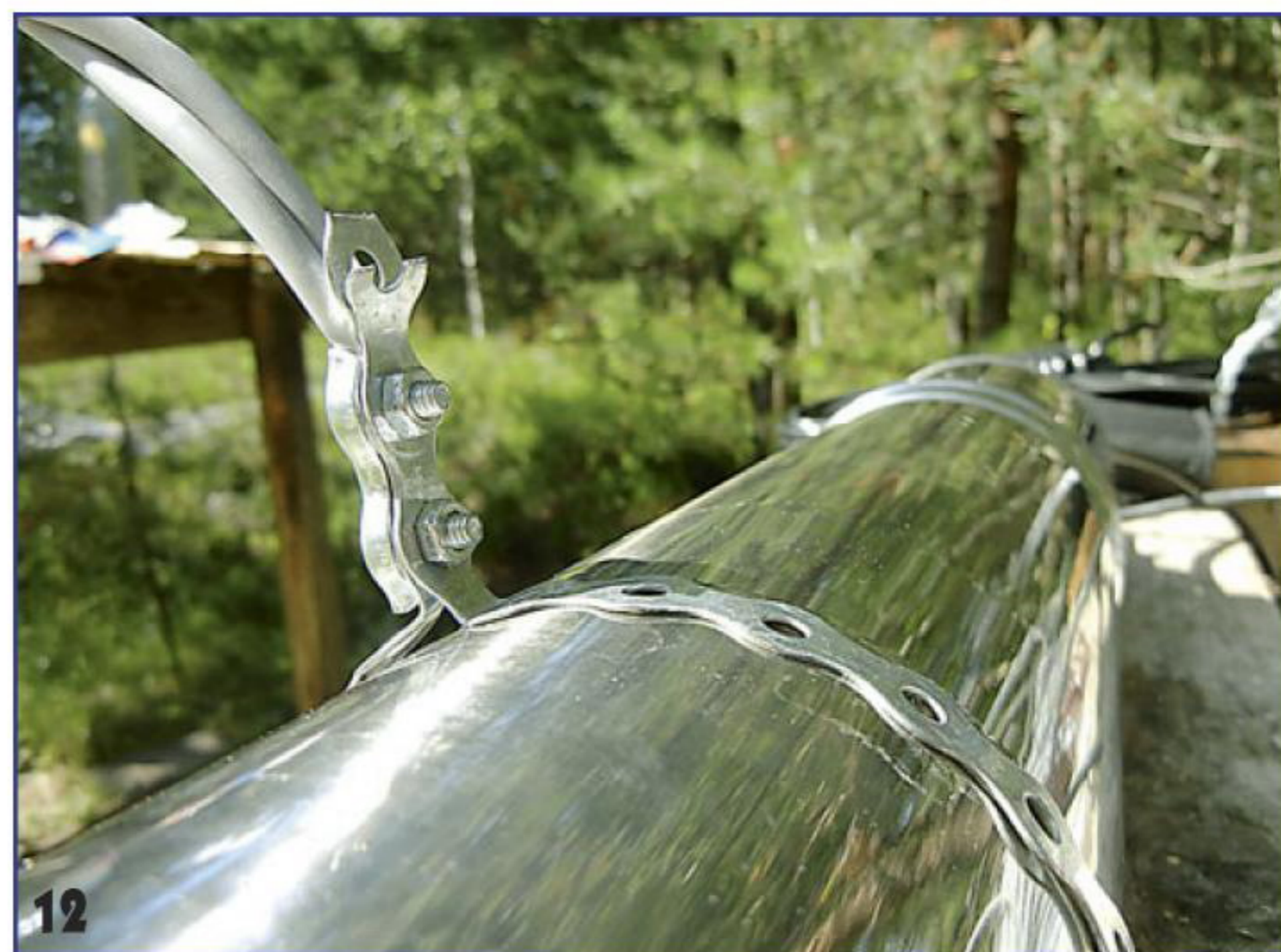
12 Хомут из оцинкованной монтажной ленты, к которому прикреплён тросик, удерживающий насос в горизонтальном положении.
